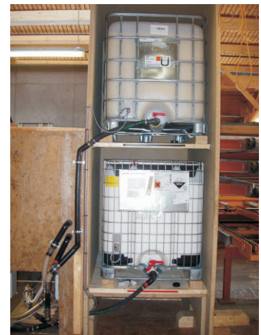
Oben Leimtank, unten Härtertank mit Füllstandkontrolle
