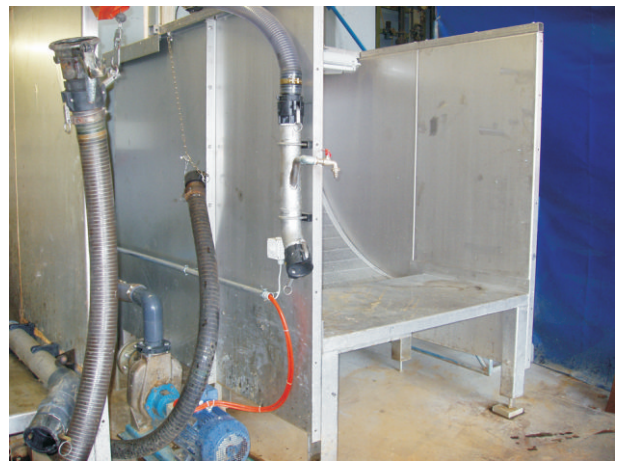
Befüllrohr mit Abzweiger zur Probenentnahme, Pumpe
